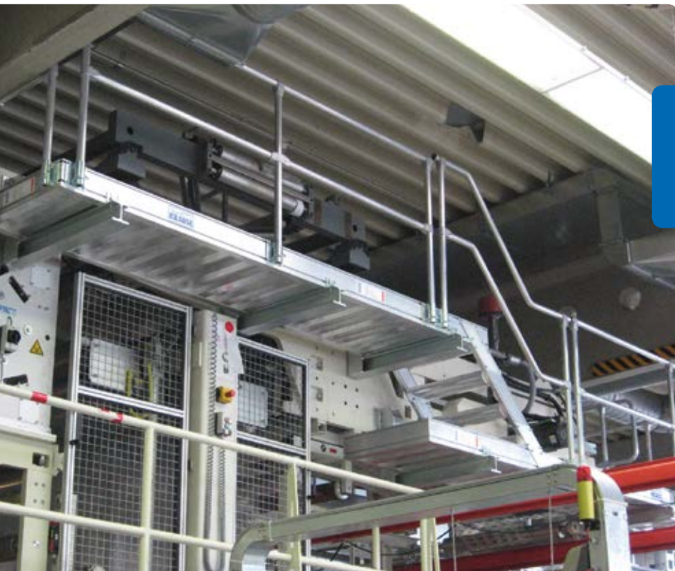
Площадка для обслуживания, на двух уровнях
