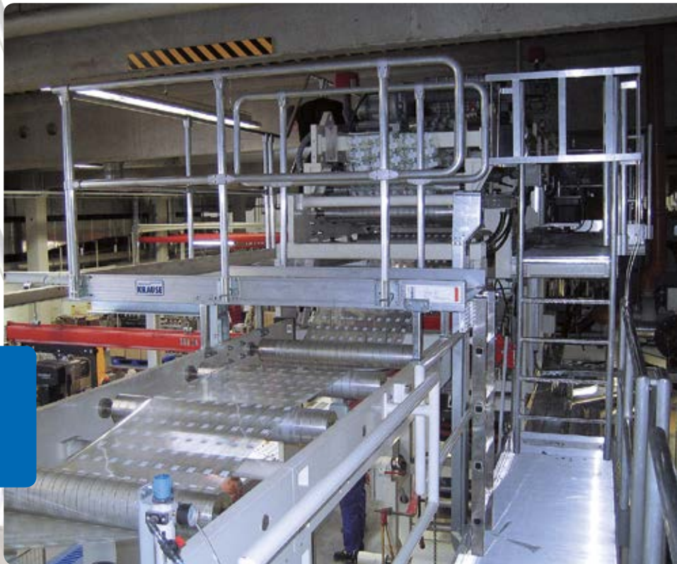
Площадка для обслуживания с вставными перилами, подъем по вертикальной лестнице
