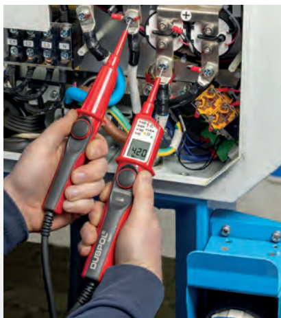
Prüfung der Ausgangsspannung einer DC-Ladeeinrichtung
