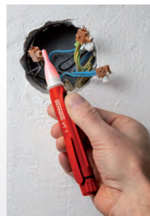
Phasenprüfung an Abzweigdose
